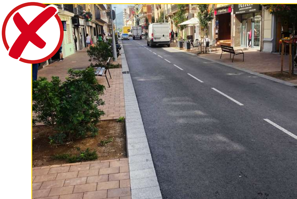
Imagen 34. Ausencia de delimitación mediante pavimento de advertencia.
