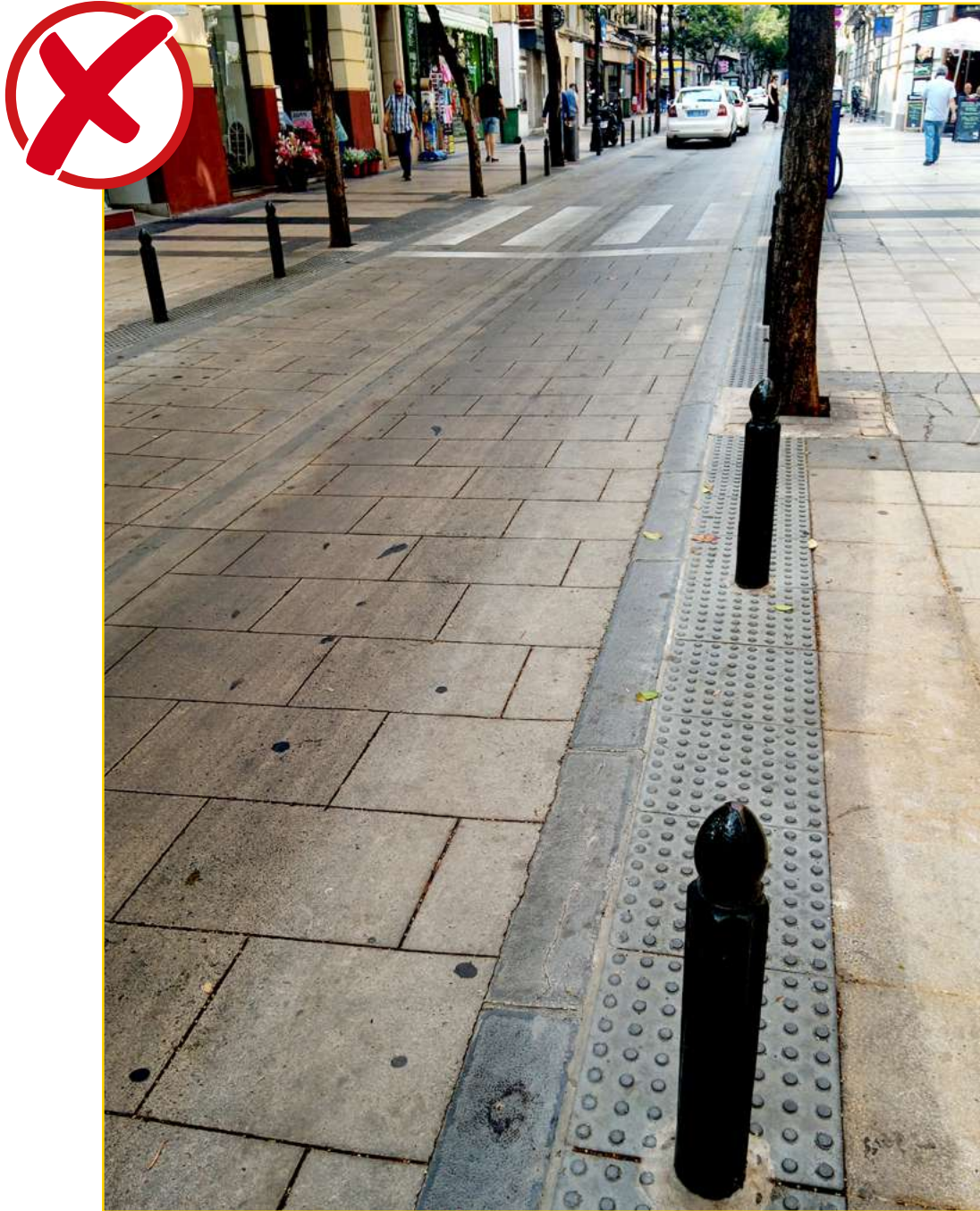
Imagen 35. No hay diferencia entre pavimento de calzada y acera.
